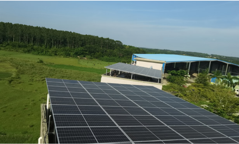
2021 年 9 月，定安混凝土光伏发电站项目通过南方电网的验收并正式并网发电
